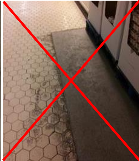
nicht geeigneter Bodenbelag
